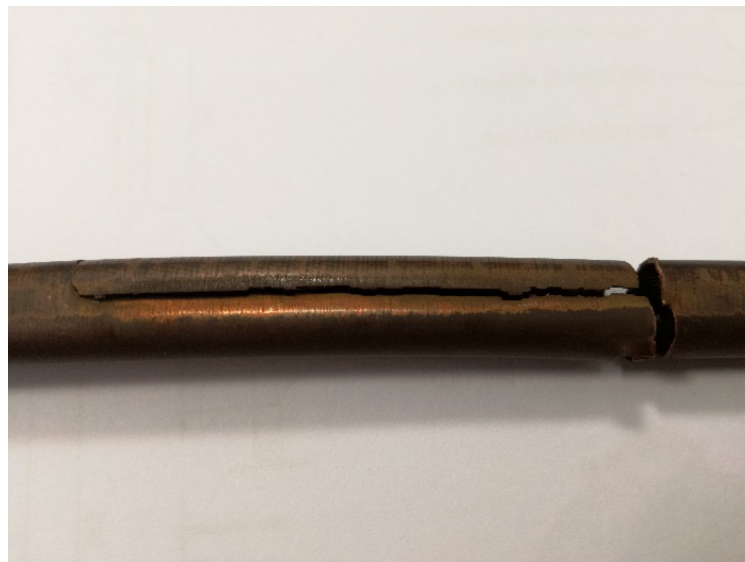
Рис. 2. Фото труби з подовжнім та поперечним розривом
