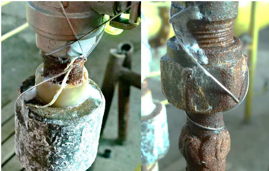
Рис. 1. Приклад порушення щільності різьбового з'єднання на ГРП
