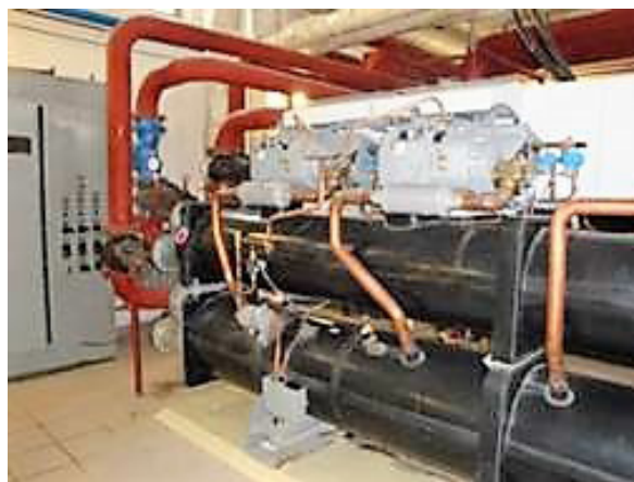
Рис. 1. Теплонасосна система гарячого водопостачання потужністю 1,5 МВт в м. Краматорськ
