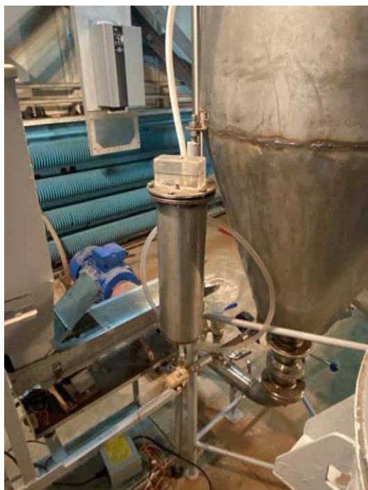
Рис. 2. Проточний водонагрівач з контролером регулювання температури
