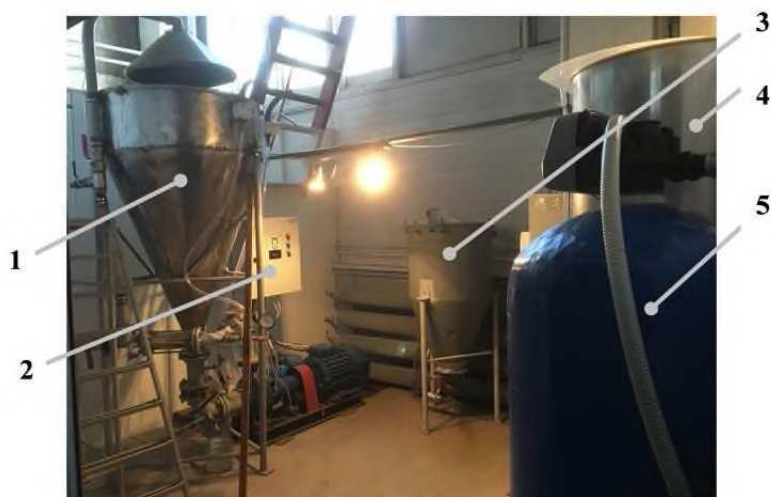
Рис. 4. Дослідно-промислове обладнання: 1 – аераційно-окиснювальна установка; 2 – блок пуску та управління; 3 – проміжна ємність подачі води на фільтр; 4 – фільтр; 5 – збірник готової продукції
