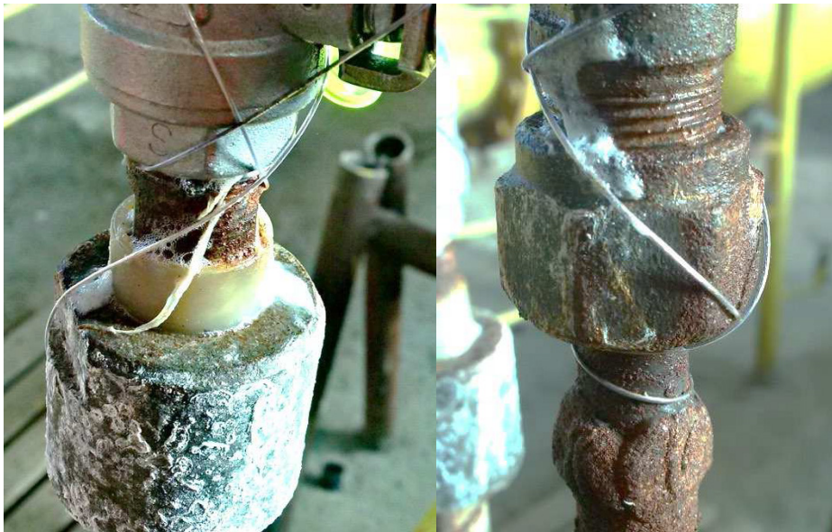
Рис. 1. Приклад порушення щільності різьбового з'єднання на ГРП
