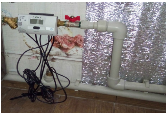
Рис. 4. Фрагмент встановлення квартирних лічильників тепла
